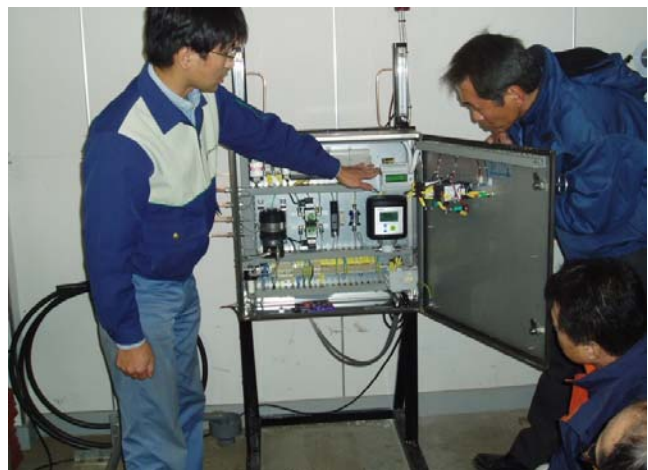
エチレンガス制御装置 (英国製) (JA 帯広かわにし 700t 貯蔵庫×2~4 室制御可能： 平成 21 年 5 月 14 日現在)
